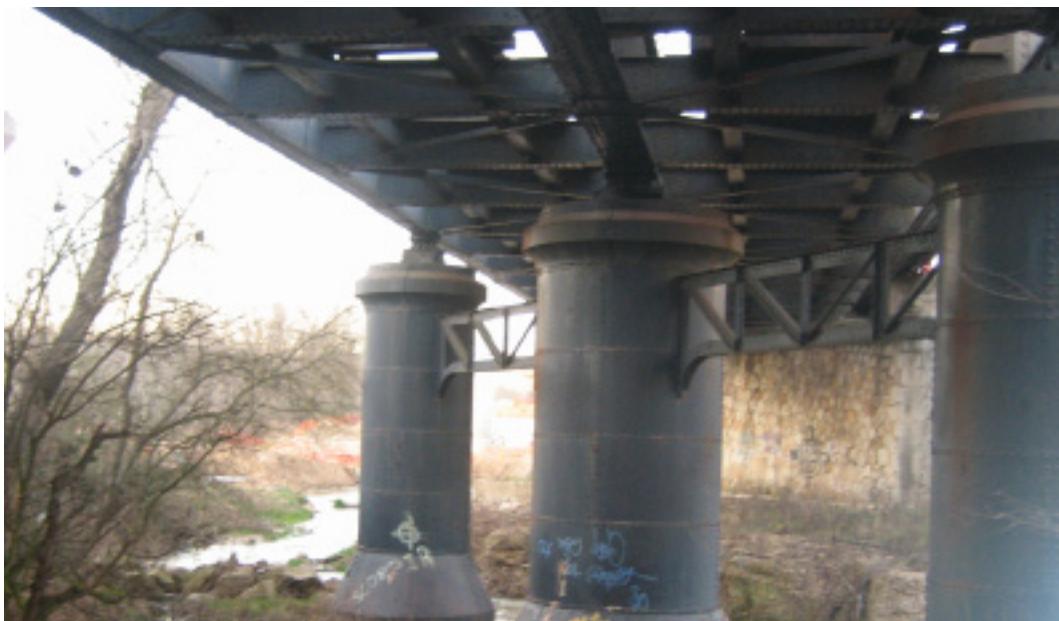
Puente de Santa Coloma antes de la intervención
